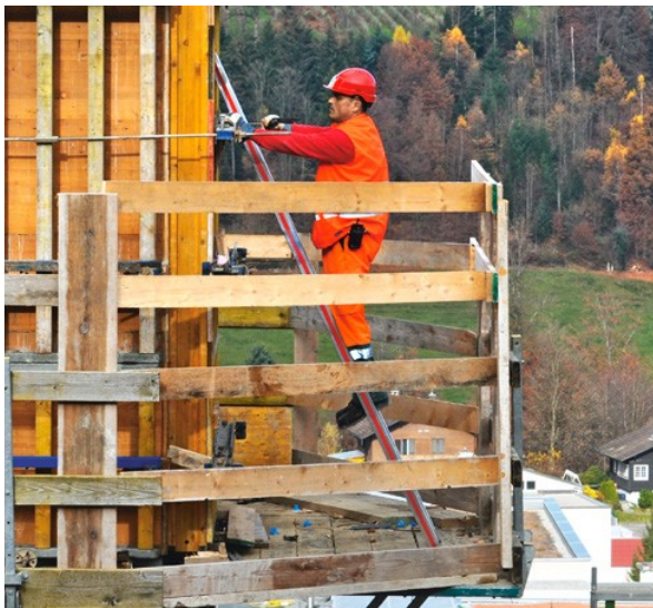
4 Zusätzliche Schutzmassnahme (hoher Seitenschutz) bei erhöhter Absturzstelle
